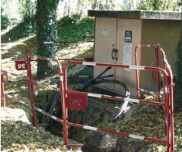
Le nouveau transformateur sur la place n'est pas encore installé
