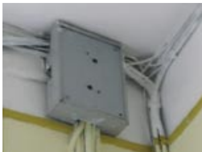
Electricité hors normes
