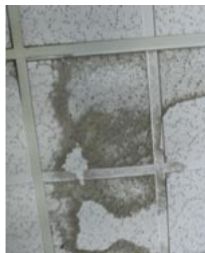
Plafond taché et isolation dégradée
