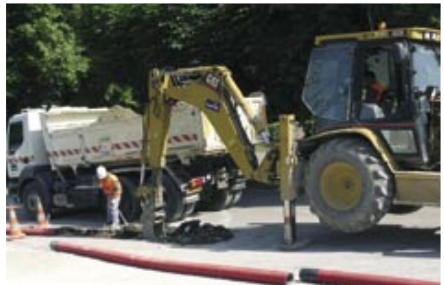
Dans les rues du village, la tranchée a été faite avec un tractopelle
