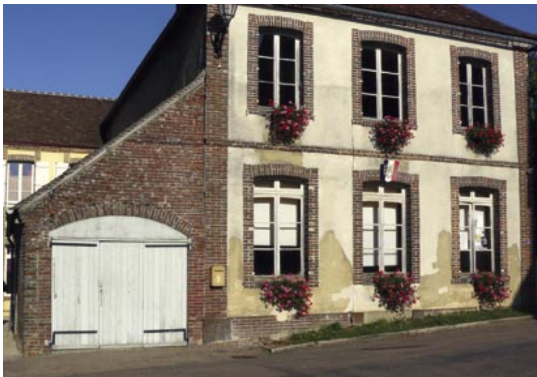
Un enduit extérieur dégradé qui donne une bien mauvaise image de marque de notre commune...
