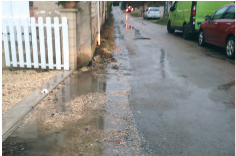
Etat de la chaussée lors de fortes pluies avant la pose de bordures
