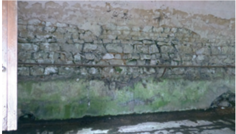
Le triste état de la partie basse du pignon avec ses pierres rongées par l'humidité
