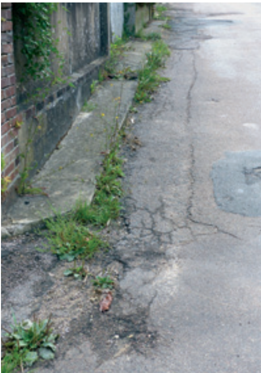
Trottoir et état de la route devant le N°6
