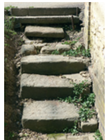
Un escalier en mauvais état
