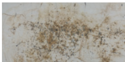
Les auréoles brunâtres dans le plafond de l'église dues aux infiltrations d'eau
