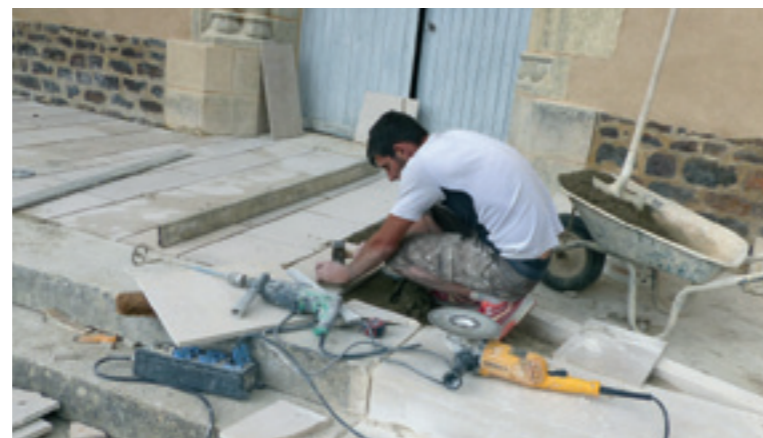
Réfection du parvis en pierre de Massangis avec mise aux normes pour l'accessibilité des personnes à mobilité réduite
