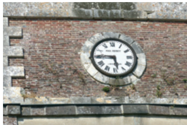
AVANT : Des pierres gelées, la végétation s'est installée dans les joints, une pierre remplacée par du ciment sous l'horloge...
