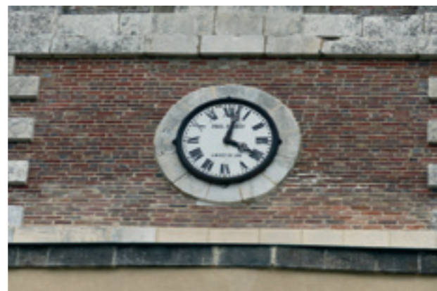
APRES : Des pierres de taille remplacées, un zinc tout neuf, des joints refaits. L'étanchéité du mur est désormais assurée
