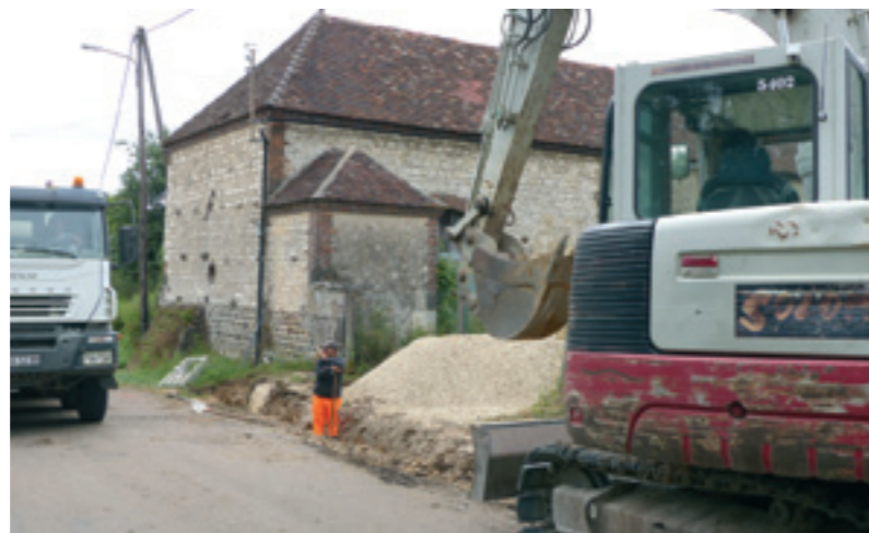
Busage d'entrée au niveau de l'ex maison Aucamus avec participation des riverains L'eau ne coulera plus sur la route, évitant ainsi la formation de verglas en hiver
