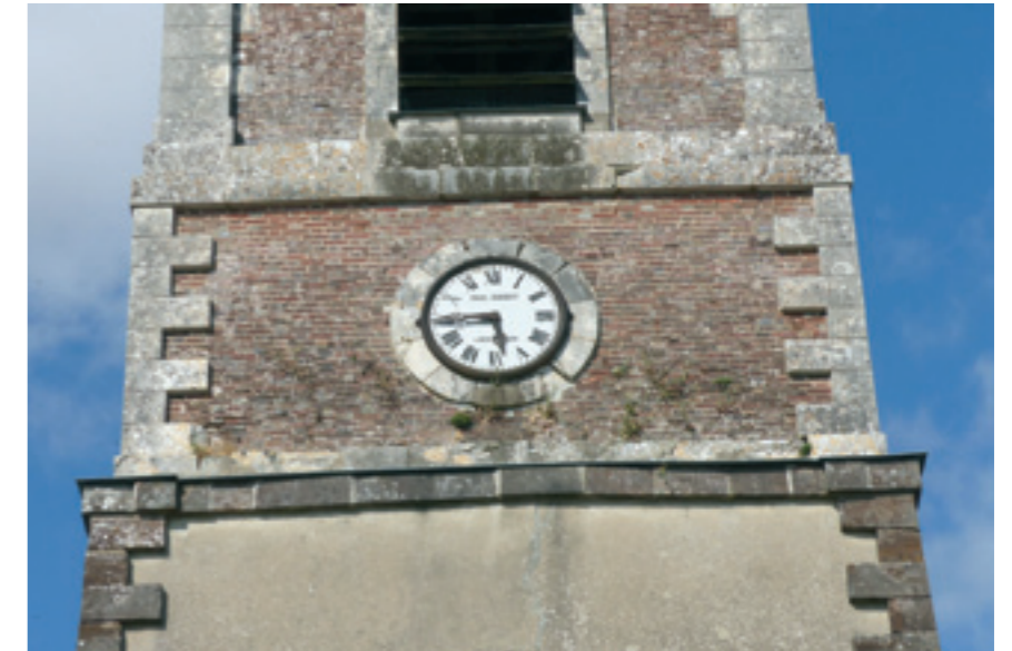
L'état de dégradation de la façade ouest du clocher
