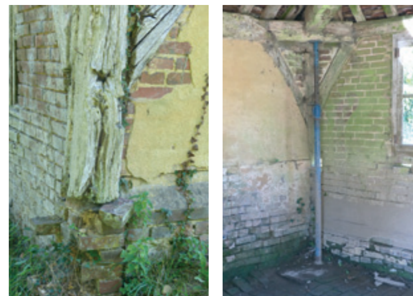
Le triste état du lavoir : un pilier de soutènement en bois dans le vide, un dallage disloqué, des murs moisissés et branlants et l'étais qui maintenant le lavoir debout...
