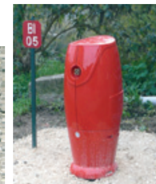
Le nouveau poteau d'incendie de Maurepas
