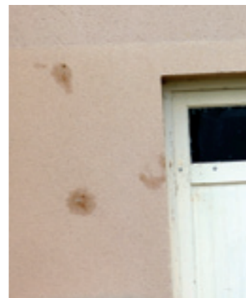
Façade arrière de la salle des fêtes tachée (enduit fait en 2010)
