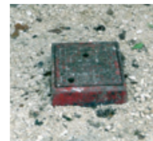
Une bouche d'incendie
