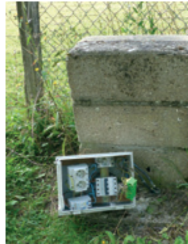
Coffret électrique arraché et défoncé
