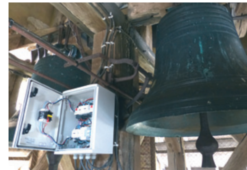
Les cloches et leur nouveau coffret de commande dans le beffroi
