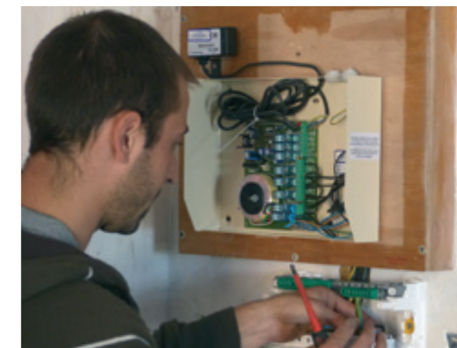
Montage et raccordement de l'horloge pilote électronique dans la sacristie avec son antenne de radio-synchronisation qui assure une précision permanente de l'heure légale
