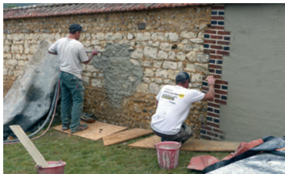
Après le piquetage, le dégrossi avant l'enduit final par l'entreprise Molinaro de chassy
