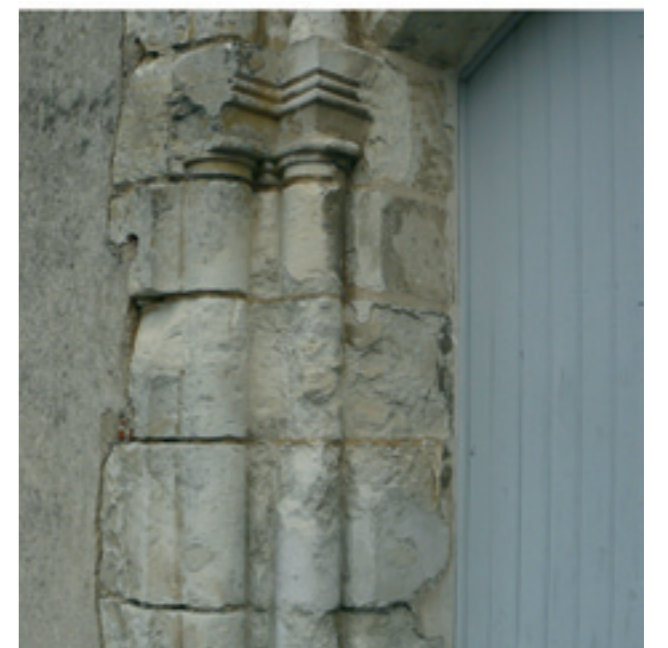
Des pierres d'encadrement du portail sont à changer
