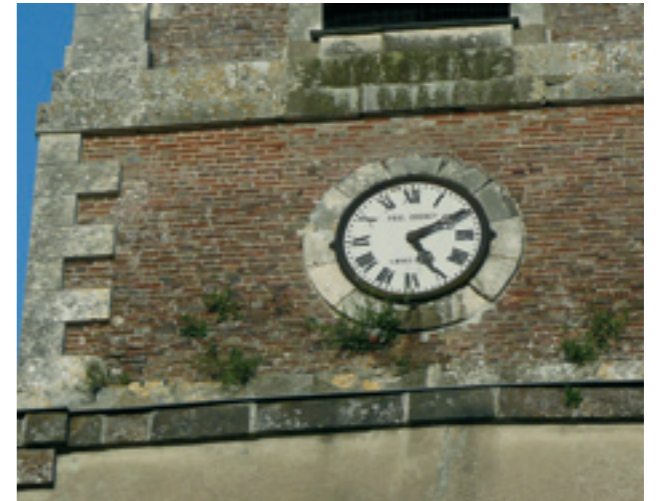
L'étanchéité de la façade sud-ouest du clocher doit être reprise, des plantes se sont installées ! Au niveau des grès, on devine le "ventre" du clocher.
