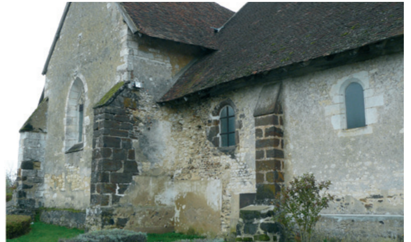
Le piteux état de la façade donnant sur la place
