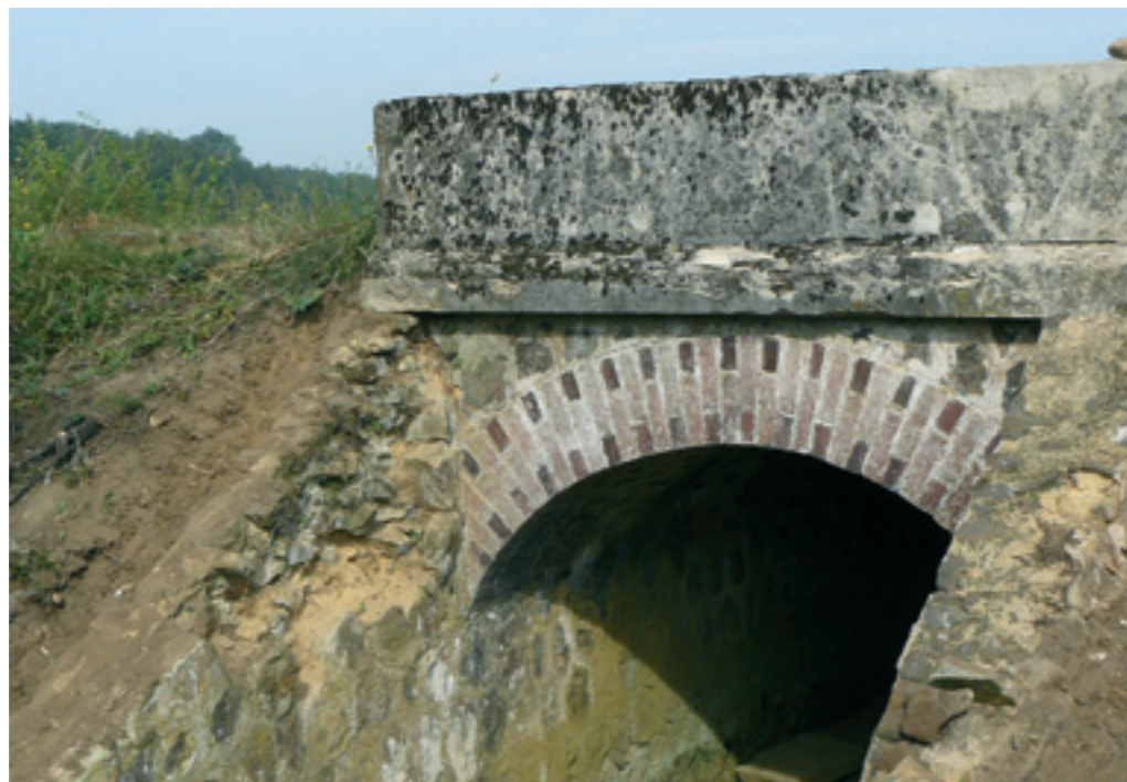
L'état des murs avant reconstruction
