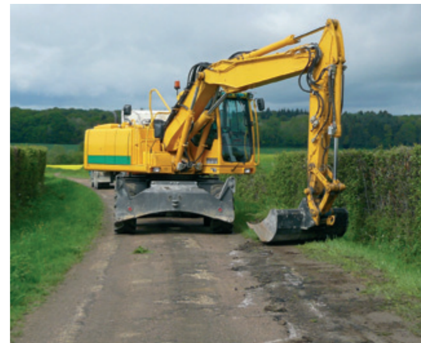
Dérasage des accotements avant le gravillonnage pour permettre aux eaux de pluie de s'écouler dans le fossé
