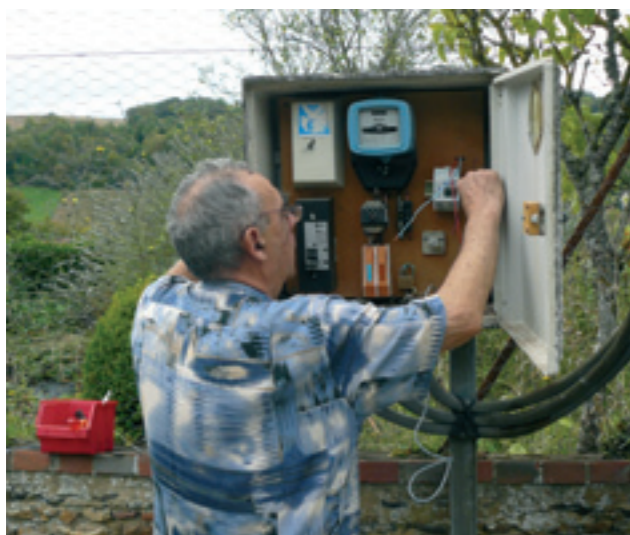
Remplacement de composants obsolètes dans l'armoire de commande du haut de la rue de Toucy
