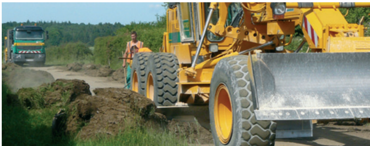
Au niveau des «Chaumes de Jeully», la route de Rhodes (VC2) formait une cuvette où stagnait l'eau. L'infiltration de cette eau dans une chaussée ayant perdu son étanchéité depuis belle lurette, combiné au passage des véhicules, avait complètement ruiné cette route. La SGREG employa les grands moyens pour déraser les accotements. La niveleuse servira aussi à étaler la grave émulsion
