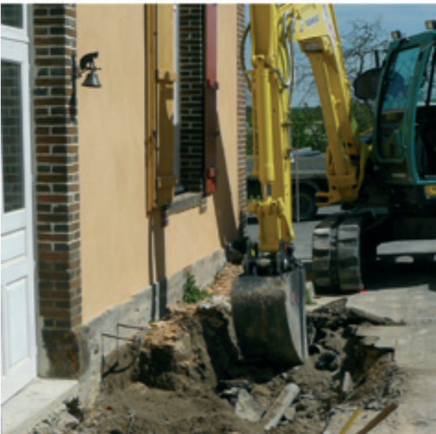
Le terrassement avant la réalisation du trottoir devant le bâtiment. Il remplace les parterres en mauvais état et régulièrement piétinés par les enfants. On aperçoit encore ce qui servait «à dépaté» les chaussures...
