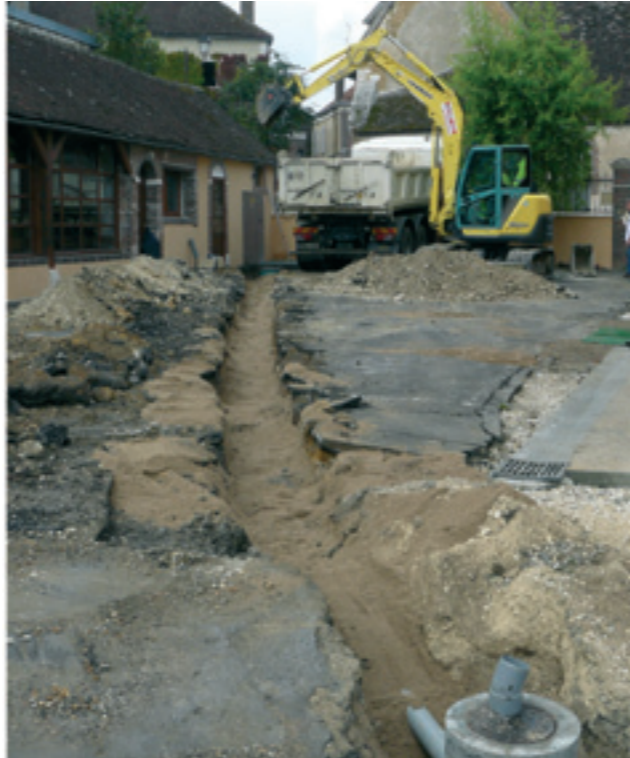
L'état de la cour après les travaux d'assainissement à partir de la cantine !
