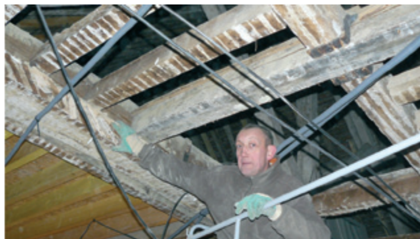
Réfection par nos soins du plafond de l'étage avec des panneaux OSB. Des solives ont été changées et des chevêtres supprimés
