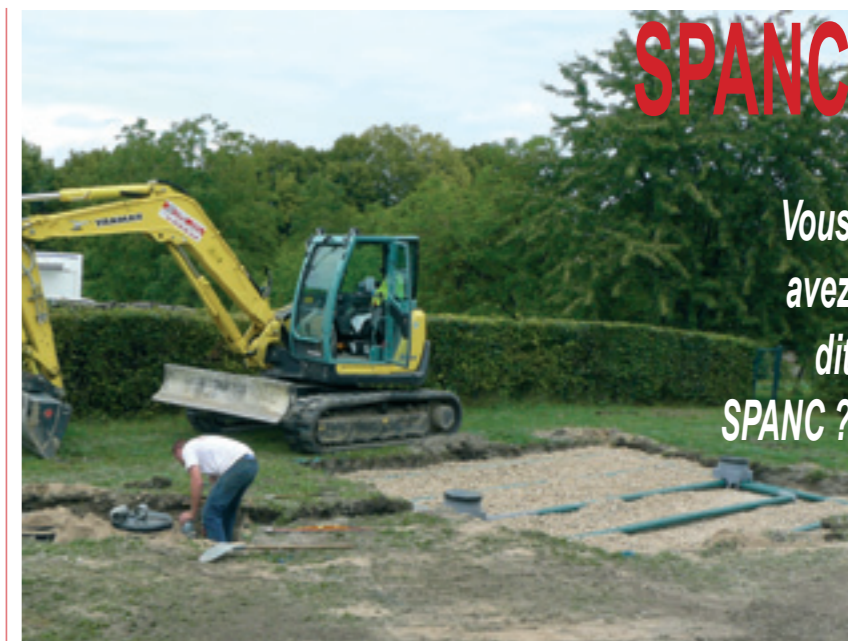
Le traitement des eaux usées du bâtiment école-mairie
