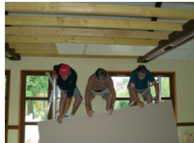
En juillet, les aménagements faits à la salle des fêtes pour nos écoliers ont été démontés. Merci à nos élèves et enseignantes qui ont laissé les locaux en parfait état
