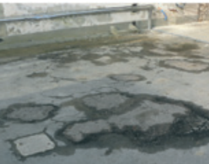
La cour de l'école était en mauvais état : canalisations des eaux pluviales obstruées et revêtement dégradé
