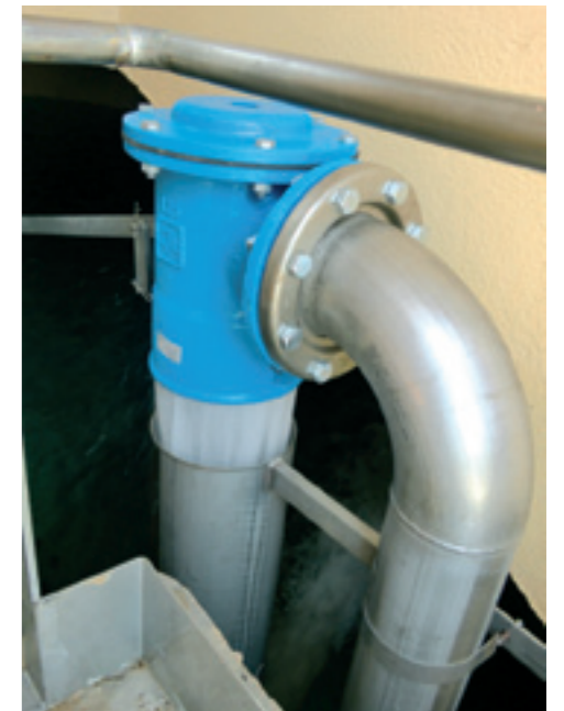
Réfection des 2 cuves de stockage, remplacement de tuyauteries en inox, ravalement extérieur... etc. Notre réservoir d'eau a pris un coup de jeune !
