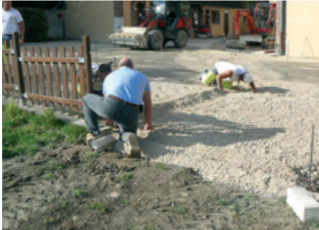
Réglage du niveau de la cour avec du calcaire avant le revêtement final
