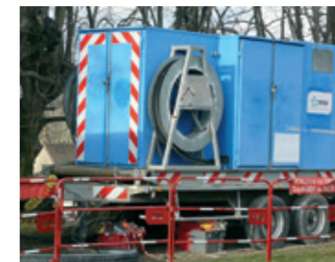
Le transformateur mobile qui alimente notre village en 220 V durant les travaux
