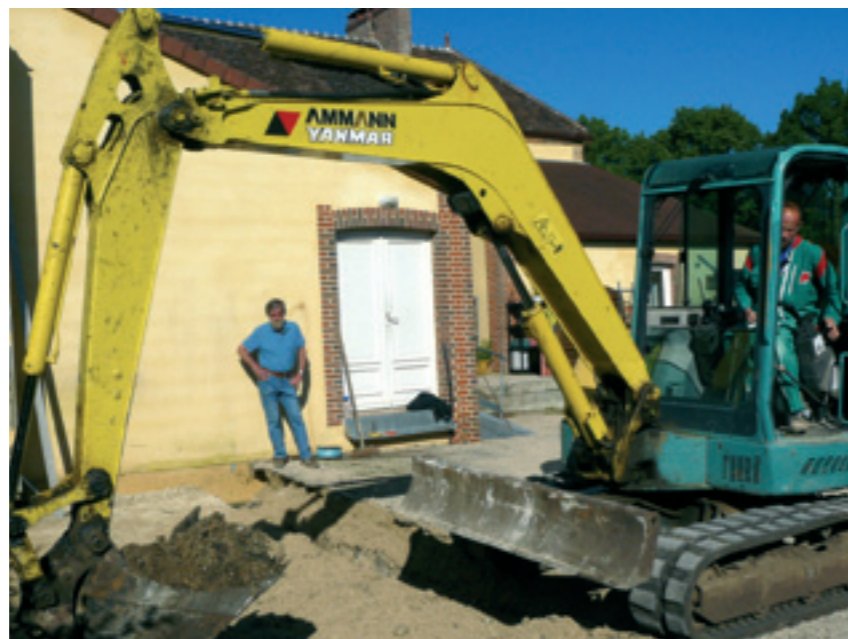
Réalisation des fondations de la remise derrière le restaurant, sous l'œil attentif du maire...
