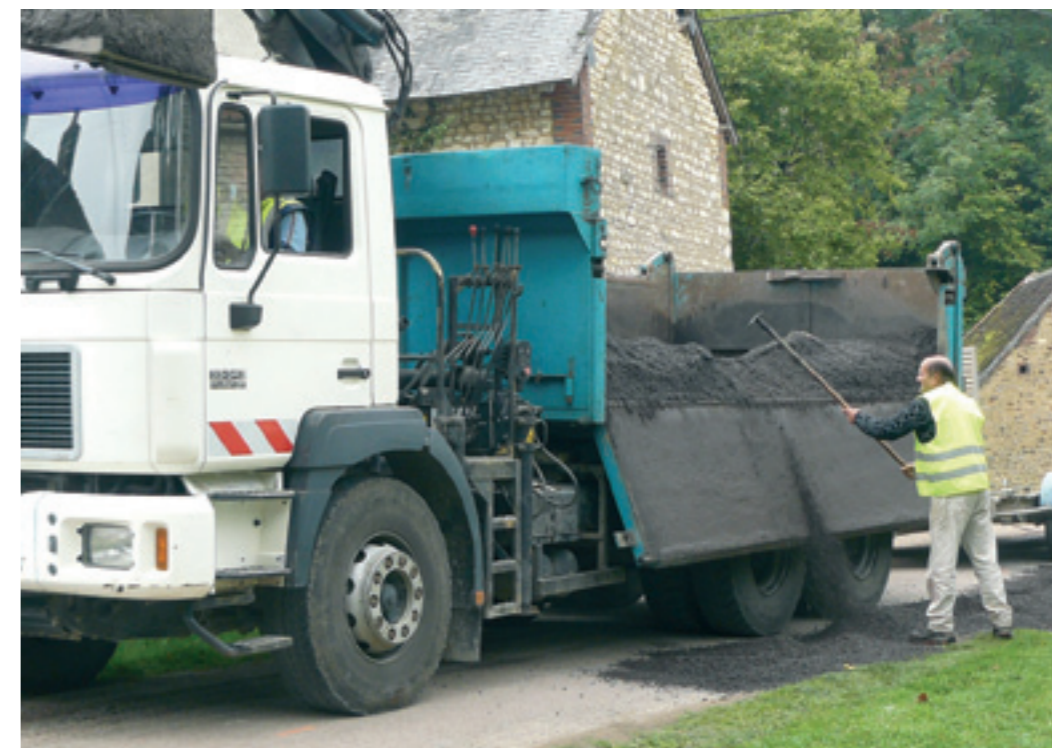
Reprofilage de la chaussée à la grave émulsion, route du Crot. La grave n'a pu être recouverte de gravillons à cause des intempéries. Ce travail est reporté au printemps
