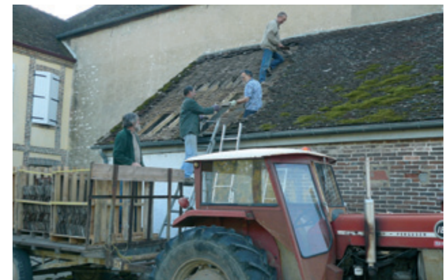
La récupération des tuiles sur le local où autrefois, le corbillard municipal était remisé
